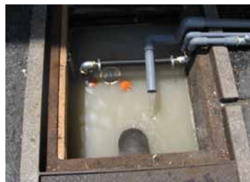
稼働後のグリストラップ
